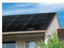
太陽光発電システム
