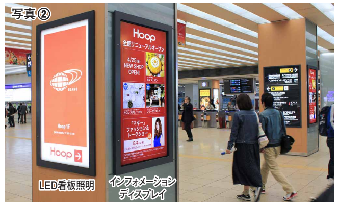
写真② LED看板照明 インフォメーションディスプレイ 通行者の動線となる箇所にはディスプレイを、それ以外はLED看板照明を設置
