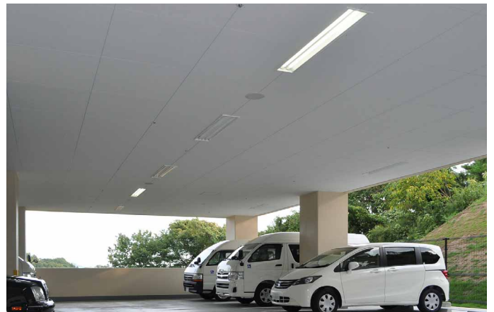
駐車場の24時間点灯する箇所にLEDを採用
