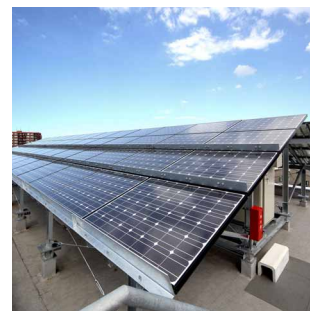
屋上には20kWの 太陽光発電システムを設置
