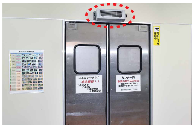
作業エリア入口には除電特化型を設置し、髪の毛などを落としやすく
