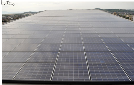
屋根全面に敷き詰められた654枚の太陽光パネル
