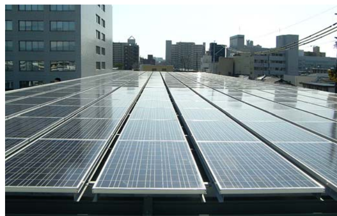
社員用駐車場の屋上に並ぶ336枚のパネル
