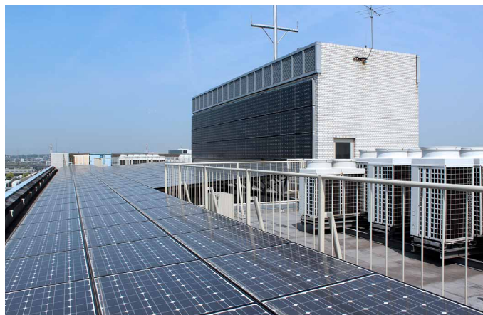
事務本館屋上のシステム(本社・富士松工場)
