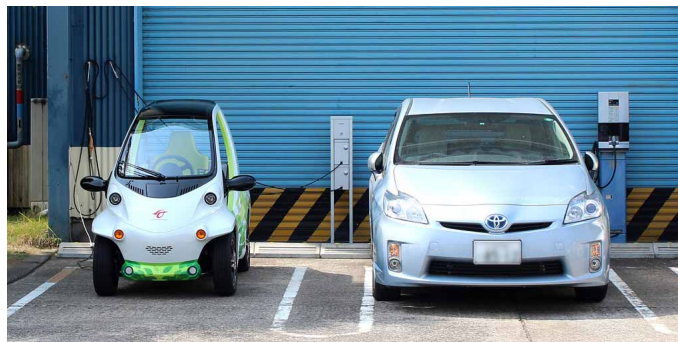
太陽光発電で創られた電力を利用して超小型電気自動車「コムス」や「プリウスPHV」を充電(本社・富士松工場)
