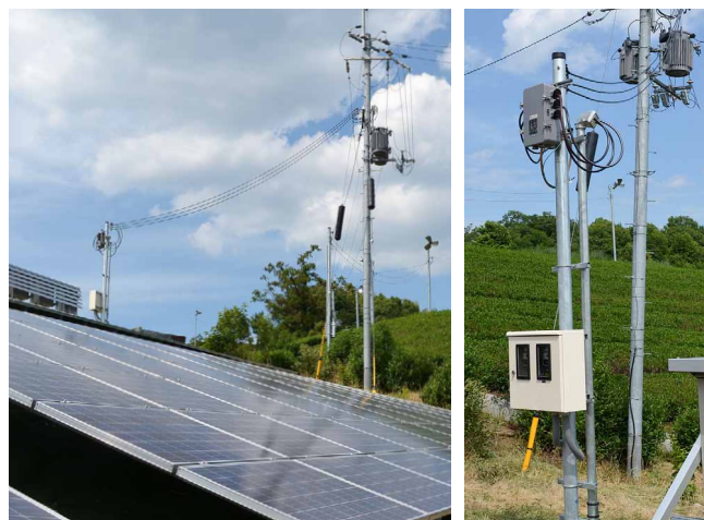
変電設備を設置せず電力系統と低圧連携し、コストを削減
