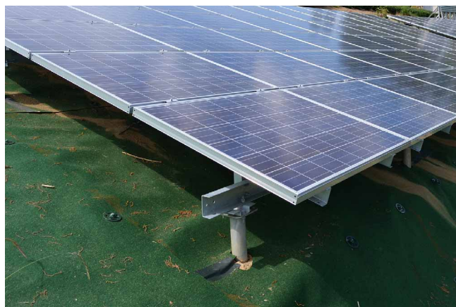
コンクリート基礎の代わりにスクリュー式の金属杭でパネルを設置
