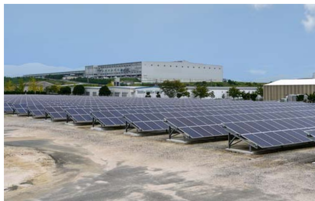
パネル設置角20度、架台の地面からの高さ488mmで年間発電量は約1.09MWh
