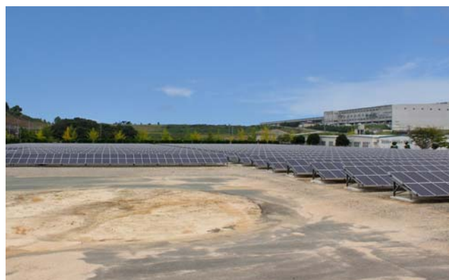
約5,500坪の工場跡地にソーラーパネル4,230枚を設置した田川市初の産業用太陽光発電所
