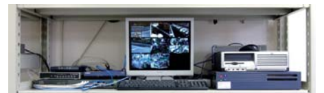
第二工場の事務所に設けられたサーバー。データを一元管理しながら、画面の切り換え操作が行われている。
